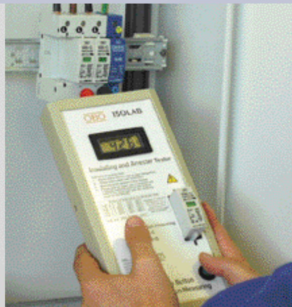
Измерение разрядников защиты от перенапряжения
