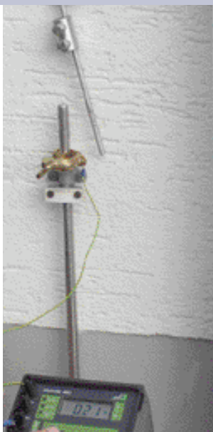
Измерение сопротивления заземления
