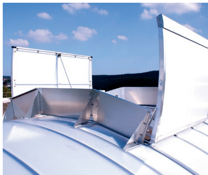
Система дымоудаления с двумя створками
